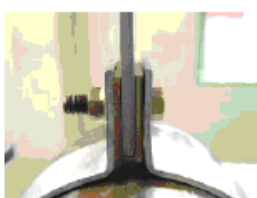
②上部に隙間がある
